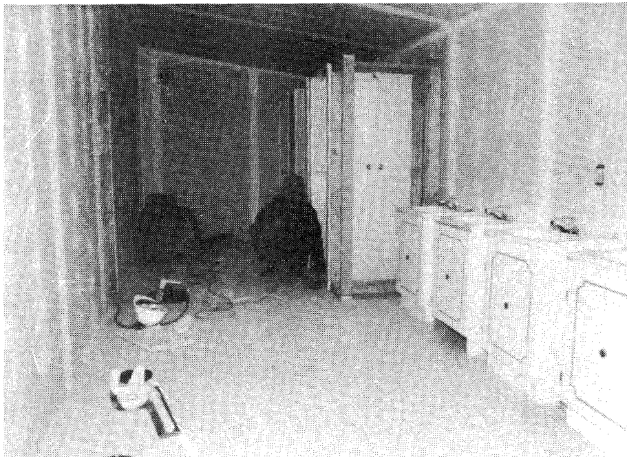
Khu nhà vệ sinh với chỗ tắm với sen, bồn rửa mặt, toilet xây đúng tiêu chuẩn. Khi báo lên khuôn, hai Nhà Vệ Sinh đã hoàn thành tốt đẹp.
